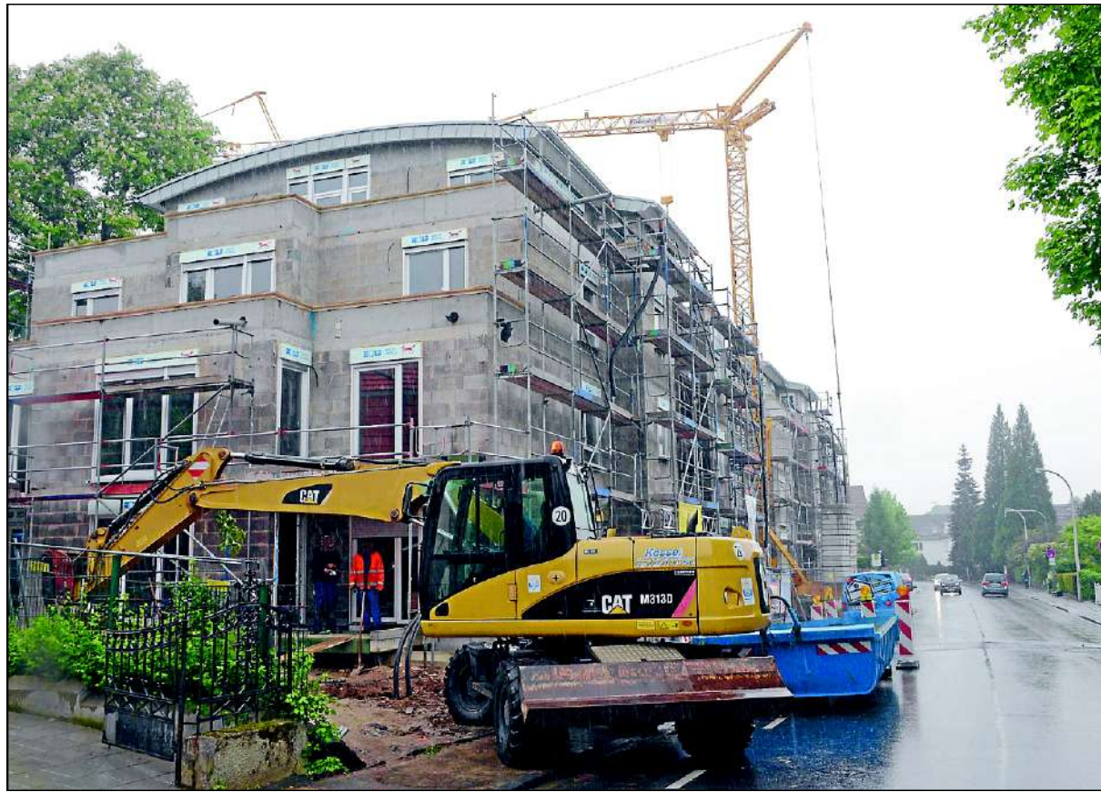
Diese zwei Mehrfamilienhäuser hat der Investor bereits an der Deutscherherrenstraße errichten lassen. Nun plant er weitere Einfamilienhäuser an der Straße An der Kelter.
